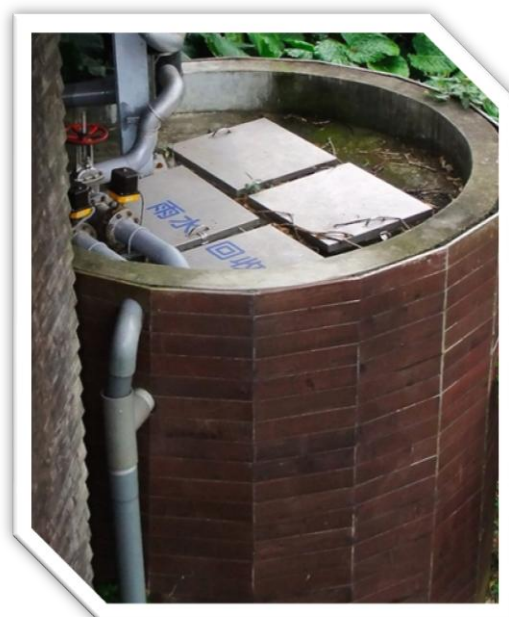
圖 5 圖書館設置的雨水儲水庫
